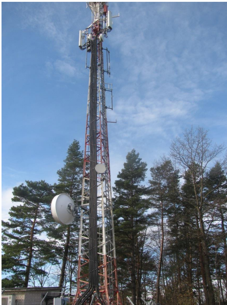
Zał. nr 1: Widok ogólny instalacji radiokomunikacyjnej.
