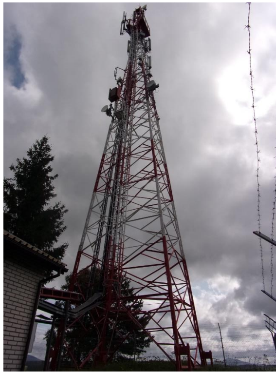
Zał. nr 1: Widok ogólny instalacji radiokomunikacyjnej.
