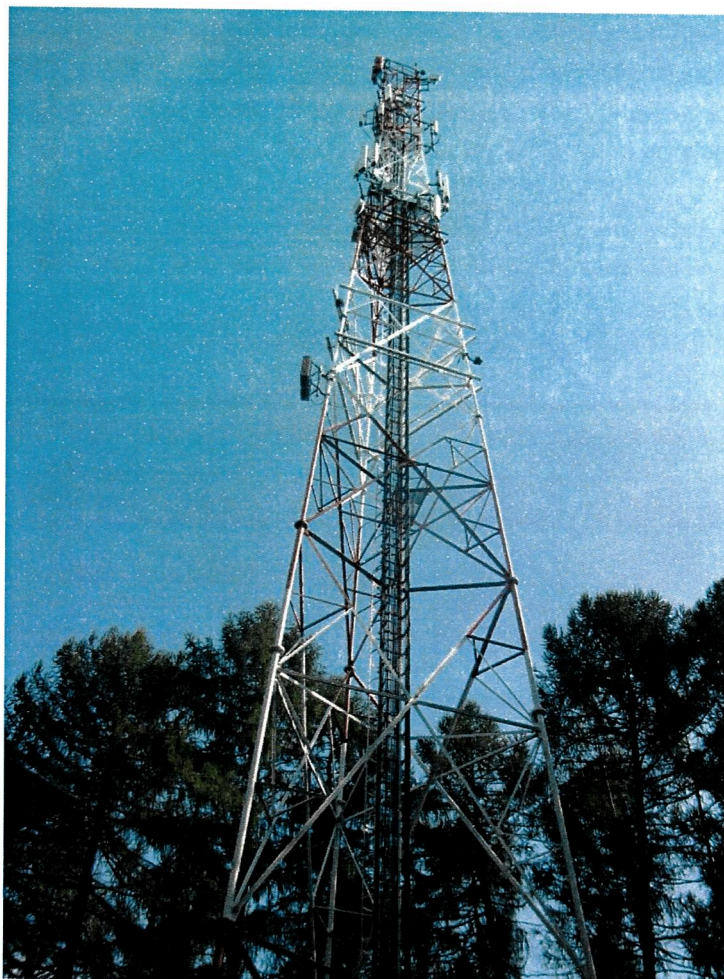
Zał. nr 1: Widok ogólny instalacji radiokomunikacyjnej.
