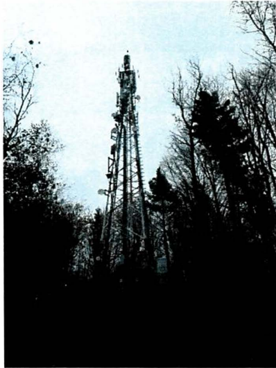
Widok obiektu wraz z zainstalowanym zespołem antenowym
