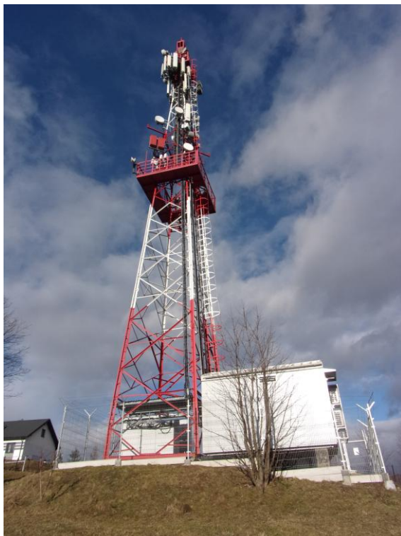
Zał. nr 1: Widok ogólny instalacji radiokomunikacyjnej.
