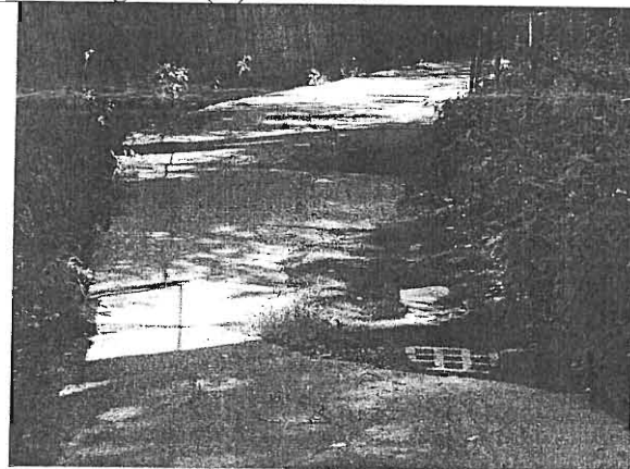
Uszkodzona droga gminna w obrębie niszy osuwiska - widok od południowego wschodu. Fot. Z. Zimnal, 31.07.2013 r.
