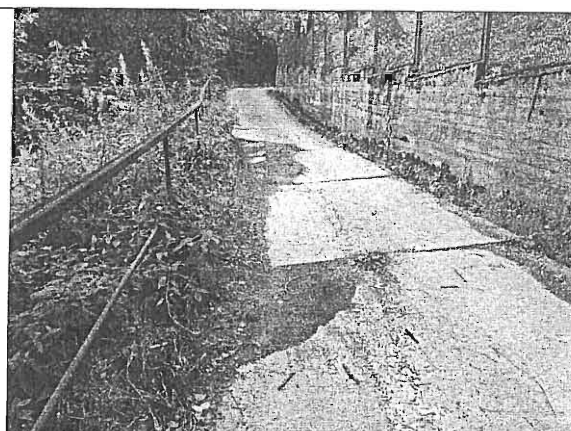
Uszkodzona droga gminna w obrębie niszy osuwiska - widok od północnego zachodu. Fot. Z. Zimnal, 31.07.2013 r.
